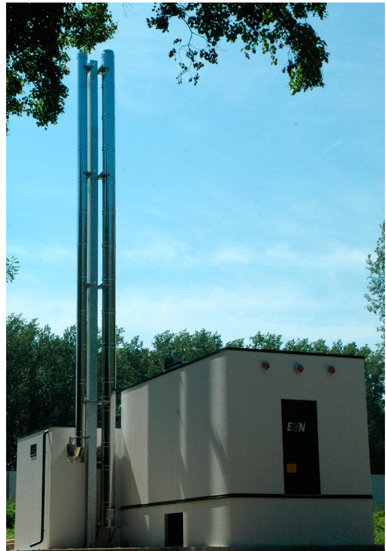
Chaudière à la biomasse.
